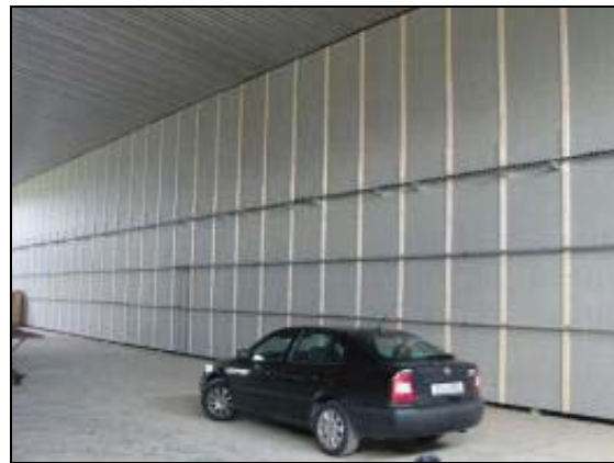
Beklædning i parkeringskælder, malet
