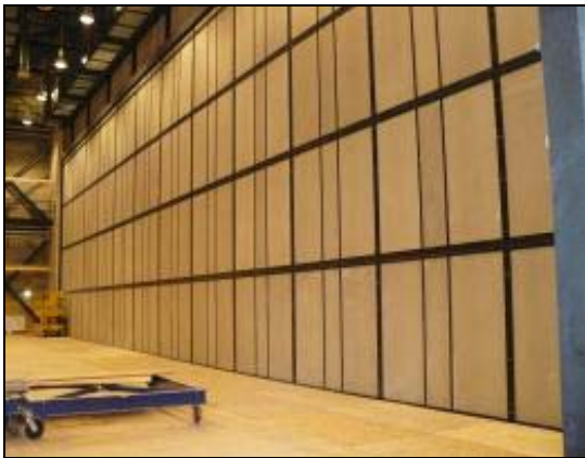
Indv. beklædning i lagerhal, ubehandlet
